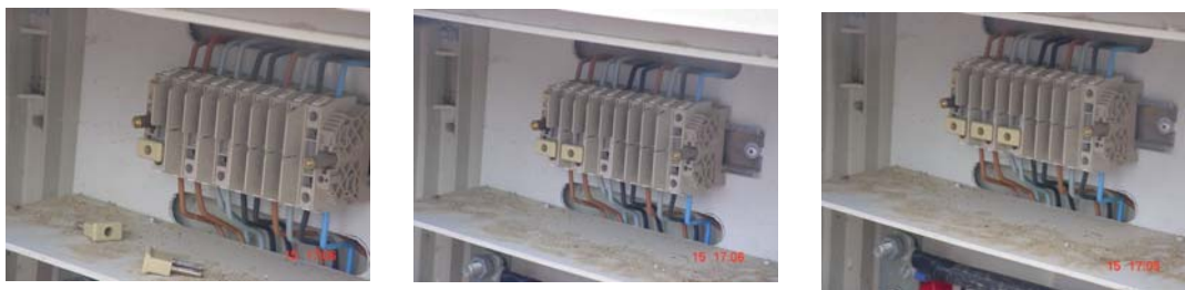
Foto 2: Colocación de los puentes en la regleta para contocuitar los secundarios de trafos de intensidad
