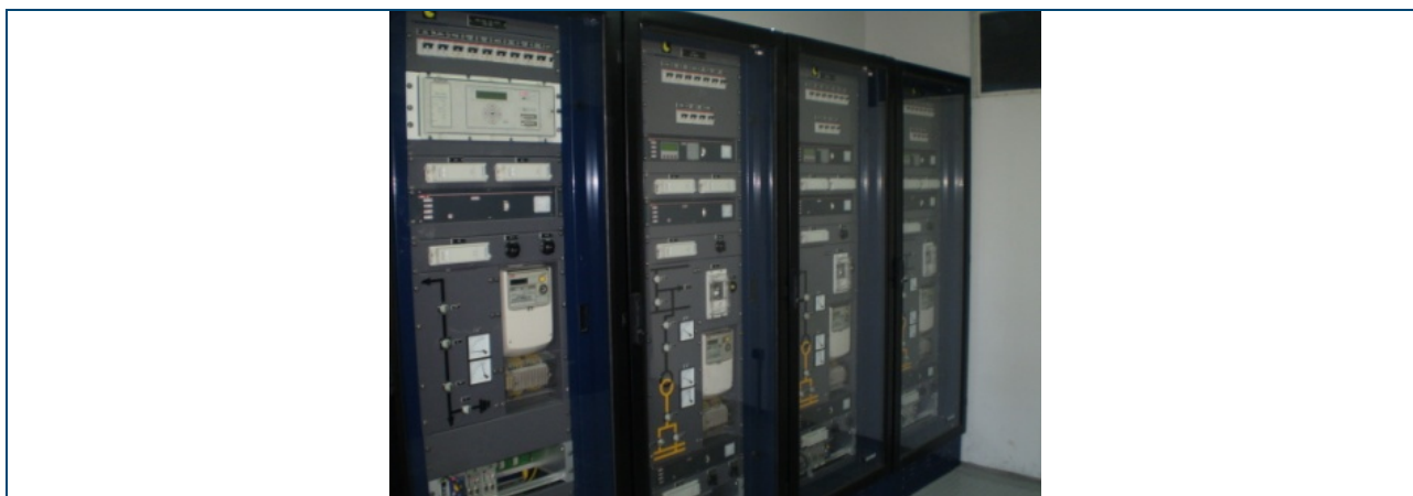
Armarios de Protecciones y Cuadro de control
