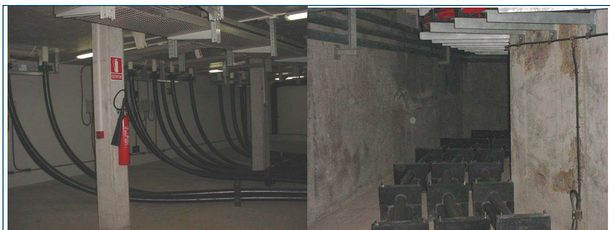
Entrada de cables de 220 kV a la subestación blindada
