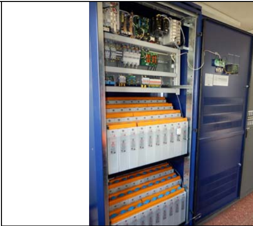
Fuente de alimentación en c.c de una subestacion
